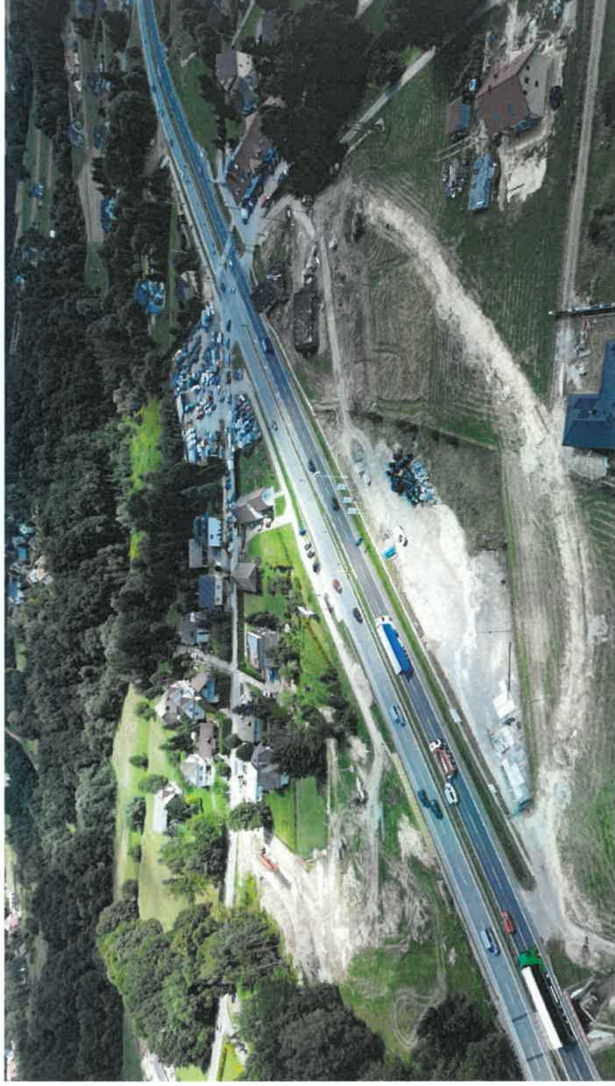
Plac budowy węzła drogowego na skrzyżowaniu DK 7 z drogą powiatową w Krzyszkowicach.
